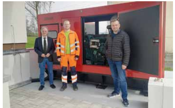
Das Notstromaggregat mit Einschaltautomatik und 250 kW Leistung. v.l.: Bgm. Dr. Martin Hundsdorfer, Wasserwart Manuel Wittmann und stellv. Geschäftsführer Michael Gruhle
